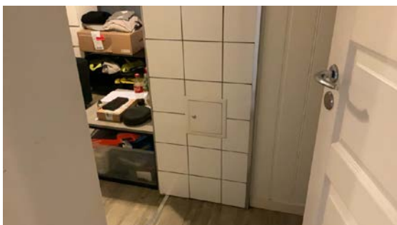
Pipe i kjeller med feiluke.
