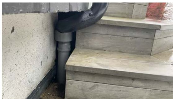
Nedløp tilkoblet overvannsrør under bakkenivå.
