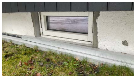
Manglende beslag under vinduer.
