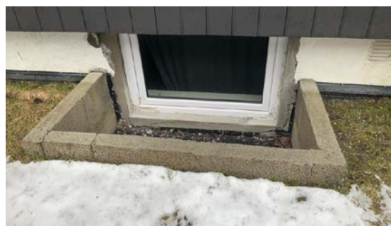
For liten høyde fra terreng til kjellervindu.
