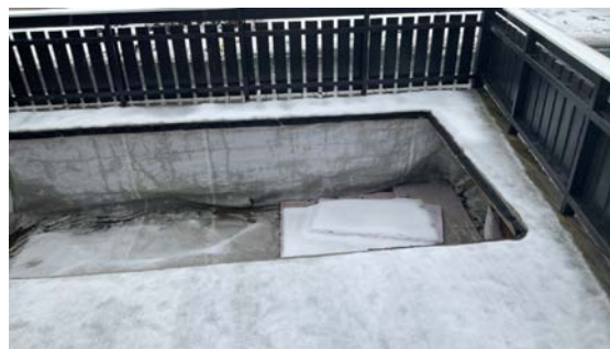
Utsparring i terrasse mangler rekkverk.
