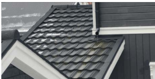
Skader på takplater på garasje.
