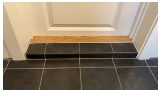
Manglende tilluft til våtrommet.
