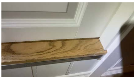
Tilluft under dør
