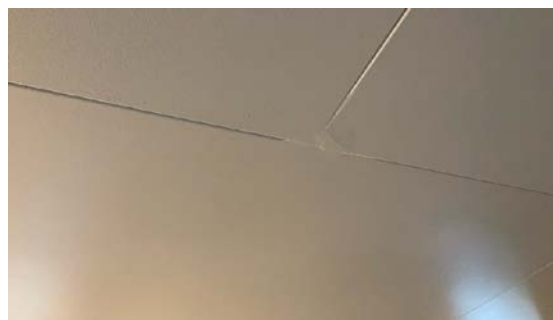
Skade i himlingsplater.
