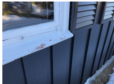
Omramming rundt vinduer er ført ned på beslag, risiko for fuktopptrekk i treverket.
