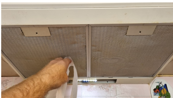
Funksjonstesting av det mekaniske avtrekket over komfyren.
