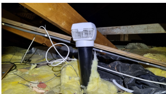
Luftingen av kloakken er på kaldloftet.
