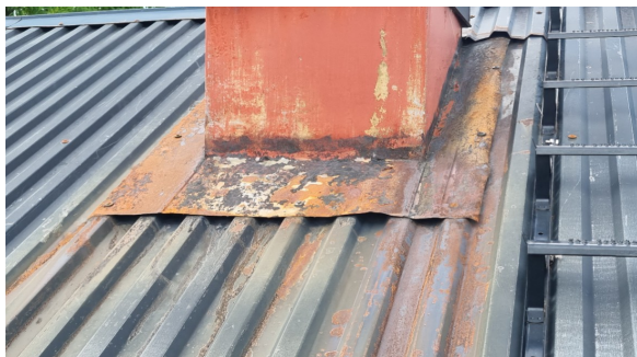
Nedre del av pipebeslaget er fra byggeår.
