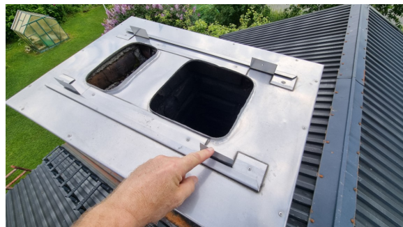
Manglende pipehatt på pipebeslaget
