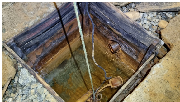
Brønn med pumpe i kjeller.
