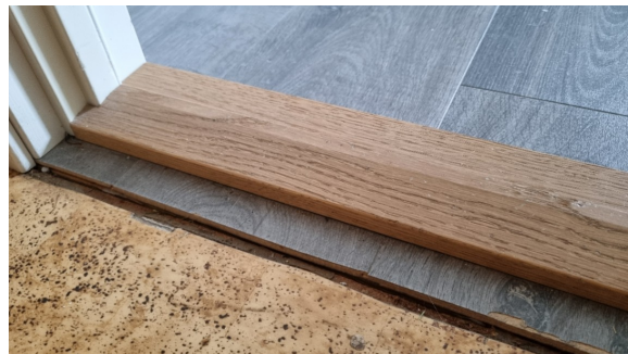
Manglende avslutninger mot dørterskel.
