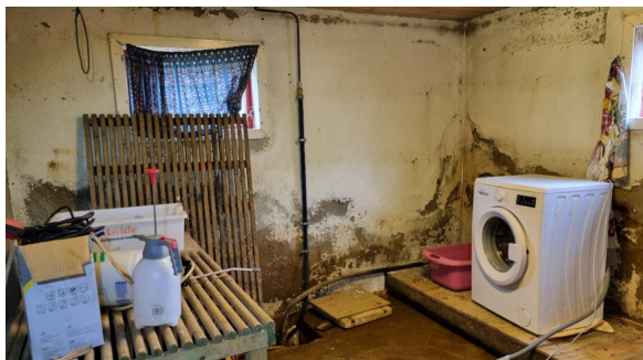
Kjelleretasjen er fuktig.
