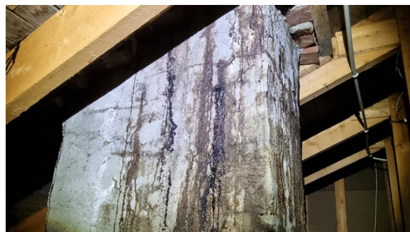
Sotvann på pipen på kaldloftet.
