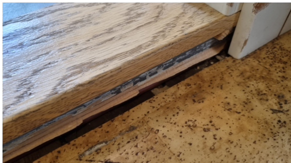
Manglende avslutninger mot dørterskel.
