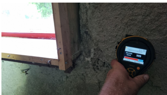
Kjelleretasjen er veldig fuktig
