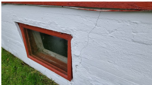
Sprekk i grunnmur
