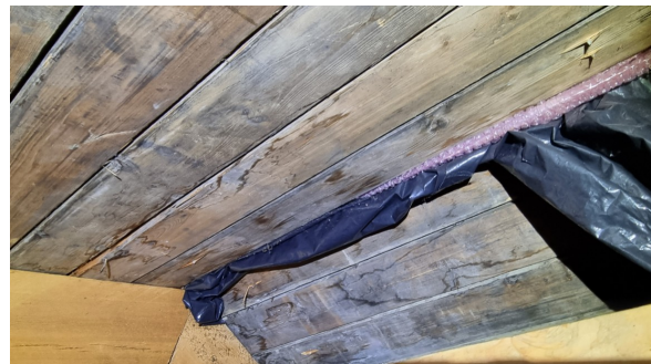
Det er stedvis tettet med søppelsekker opp under mønepanne.
