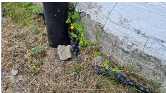
Grunnmursplast er lagt feil vei.
