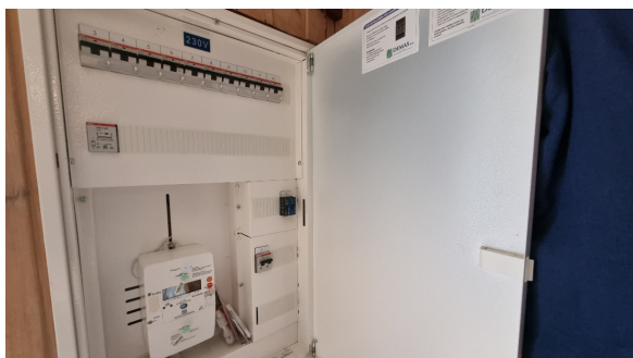
Kontroll av el-skabet.
