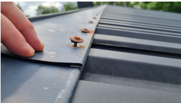
Stedvis har innfestningen begynt å løsne.
