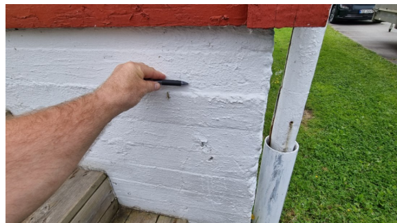
Riss i grunnmur.
