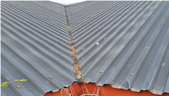
Stedvis rust og stedvis bulker i taktekket.
