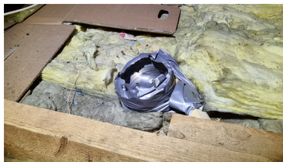
Ventilasjonskanal er kun ledet til kaldloftet.
