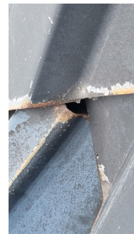
Utettheter mellom mønepanne på arken og taktekket.
