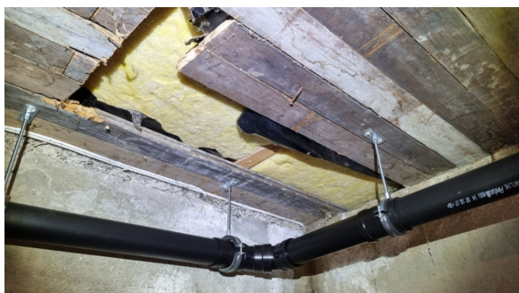
Åpen isolasjon i kjeller.
