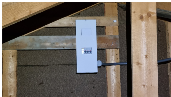
Inntakssikringer er på kaldloftet.
