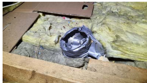
Ventilasjonskanal er kun ledet til kaldloftet.
