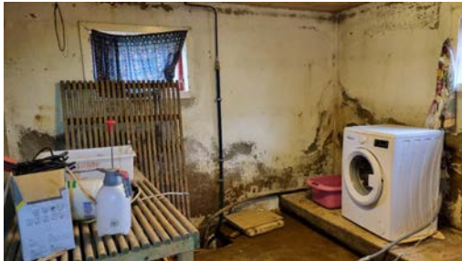
Kjelleretasjen er fuktig.
