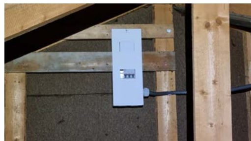
Inntakssikringer er på kaldloftet.
