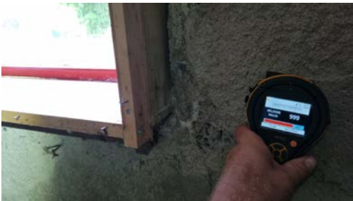
Kjelleretasjen er veldig fuktig
