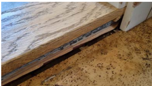
Manglende avslutninger mot dørterskel.
