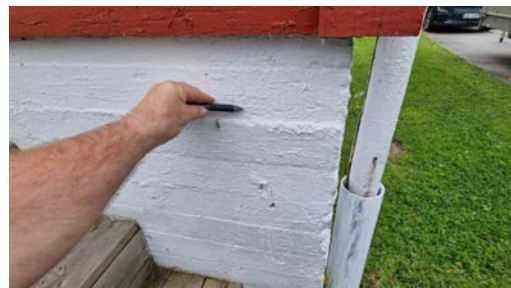
Riss i grunnmur.
