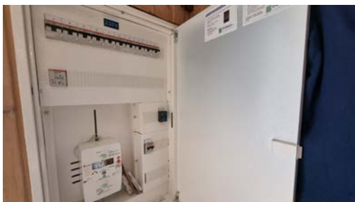
Kontroll av el-skabet.
