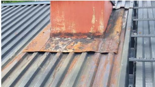
Nedre del av pipebeslaget er fra byggeår.
