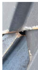
Utettheter mellom mønepanne på arken og taktekket.
