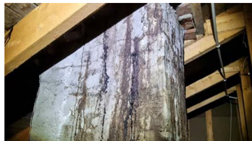
Sotvann på pipen på kaldloftet.
