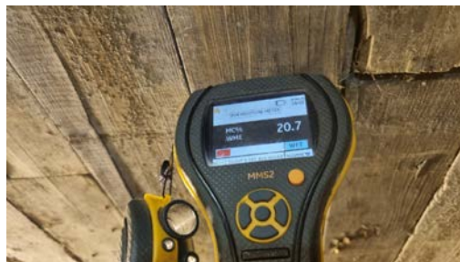
Fuktmåling i stubbloft i kjelleretasjen, forhøyede fuktverdier ble registrert. Dette skyldes det fuktige miljøet i kjelleretasjen.
