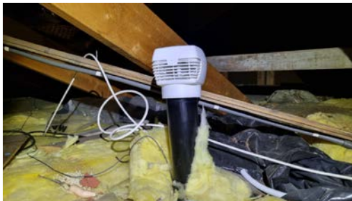
Luftingen av kloakken er på kaldloftet.
