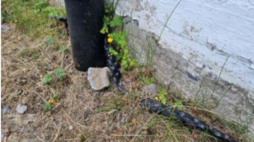
Grunnmursplast er lagt feil vei.
