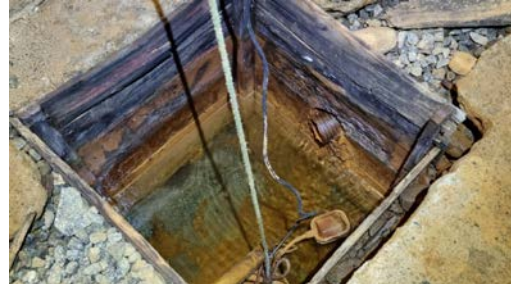
Brønn med pumpe i kjeller.
