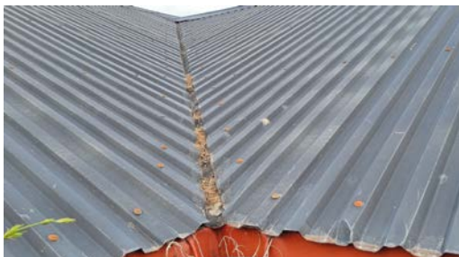
Stedvis rust og stedvis bulker i taktekket.
