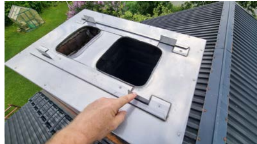
Manglende pipehatt på pipebeslaget
