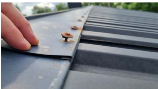
Stedvis har innfestningen begynt å løsne.
