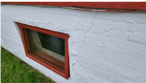
Sprekk i grunnmur
