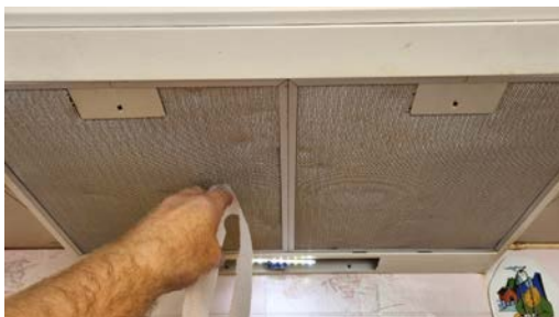
Funksjonstesting av det mekaniske avtrekket over komfyren.
