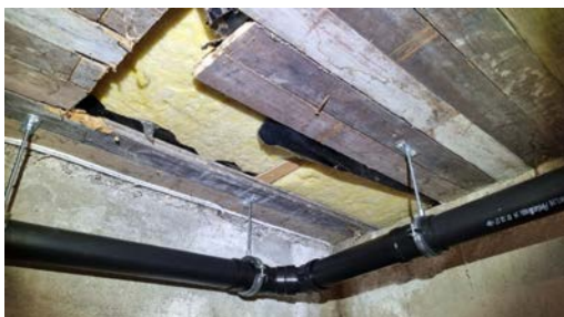
Åpen isolasjon i kjeller.
