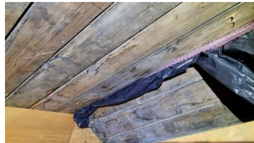
Det er stedvis tettet med søppelsekker opp under mønepanne.
