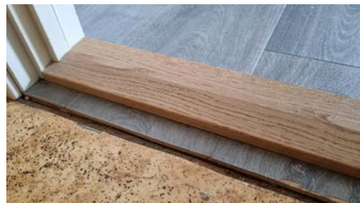
Manglende avslutninger mot dørterskel.
