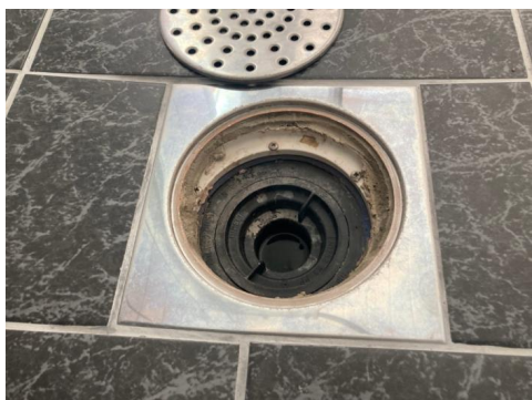
Sluk i dusjsone.
