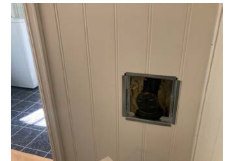
Stakeluke for avløpsrør.
