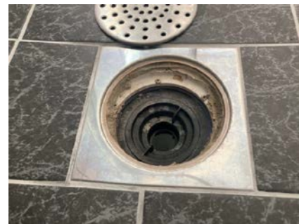
Sluk i dusjsone.
