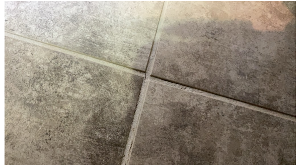
Sprekker i fuger
