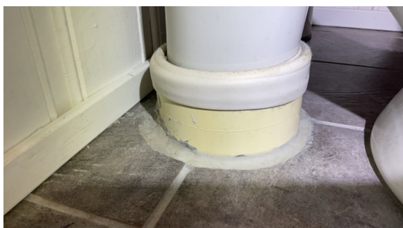
Utett gjennomføring i gulv
