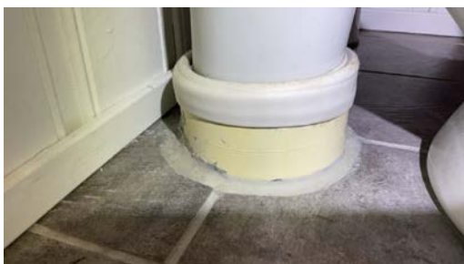
Utett gjennomføring i gulv
