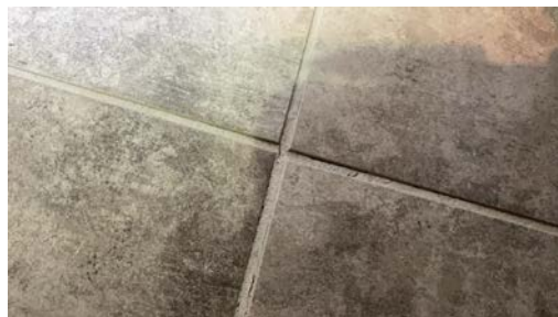
Sprekker i fuger
