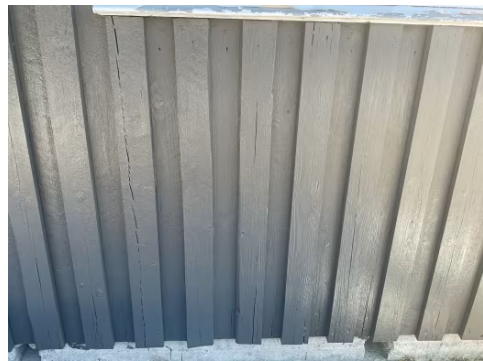
Sprekker i kledning.
