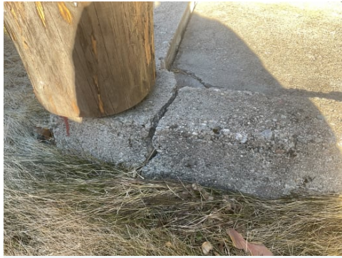
Sprekker i ringmur.
