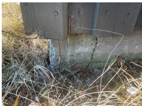
Sprekker i ringmur.
