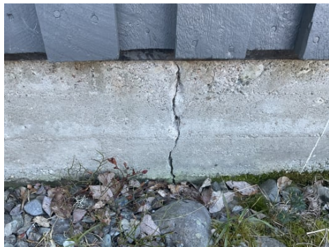
Sprekker i ringmur.
