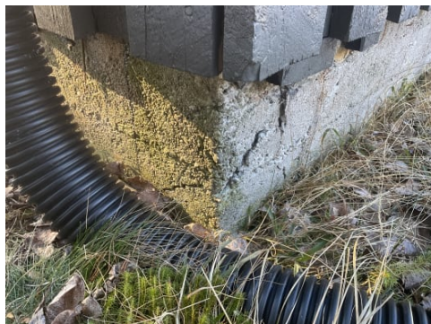
Sprekker i ringmur.
