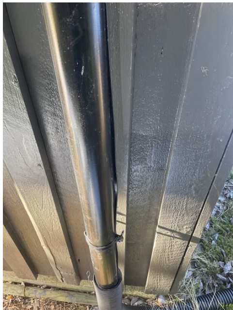
Frostsprenge i nedløp.
