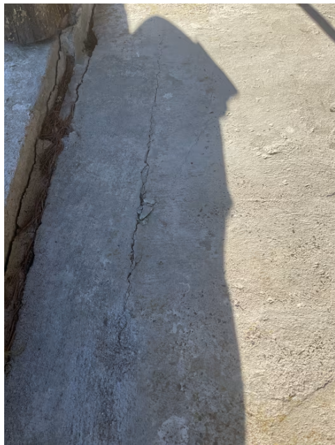
Sprekker og sakder i terrasse.
