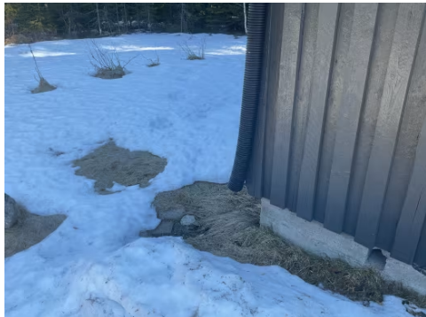
Manglende bortledning av vann.
