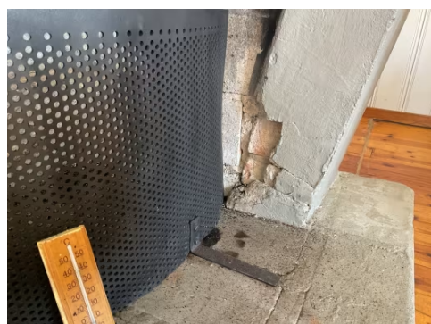
Skade på peis.
