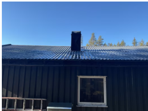
Manglende snøfangere og adkomst for feier.
