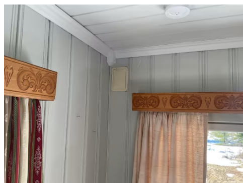
Klaffventiler på yttervegg.
