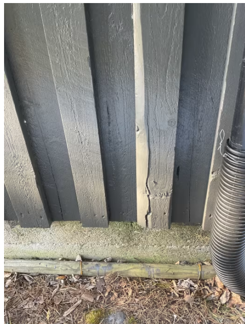
Sprekker i kledning.
