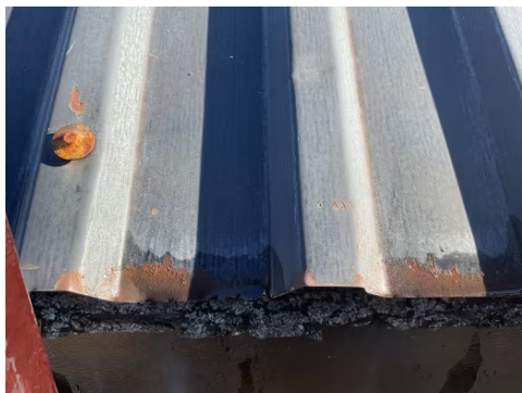
Rust i takplater.
