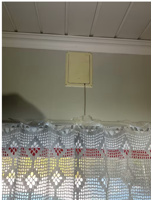
Klaffventiler på yttervegg.
