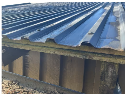
Rust og bulker i takplater.
