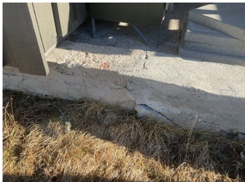
Sprekker i ringmur.
