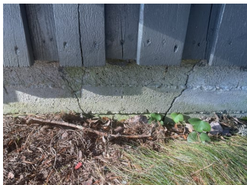
Sprekker i ringmur.
