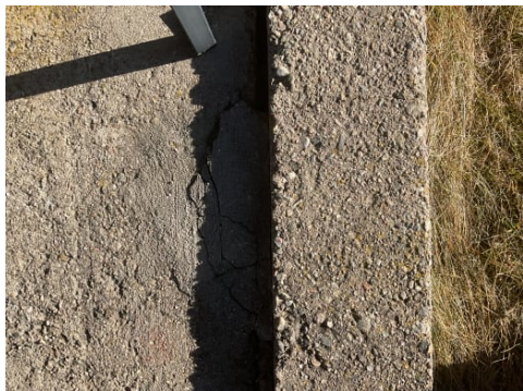
Sprekker og sakder i terrasse.
