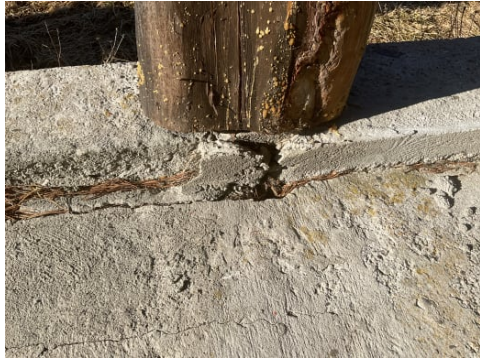
Sprekker og sakder i terrasse.
