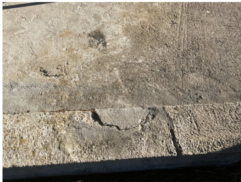
Sprekker og sakder i terrasse.
