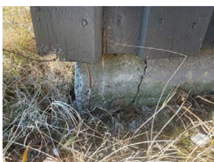
Sprekker i ringmur.
