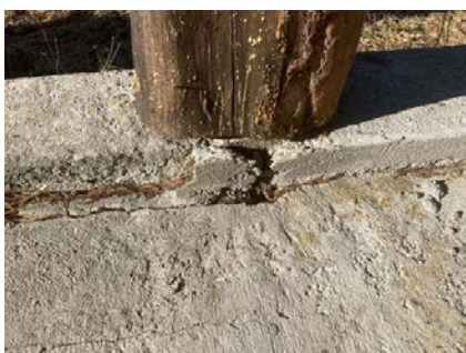
Sprekker og sakder i terrasse.
