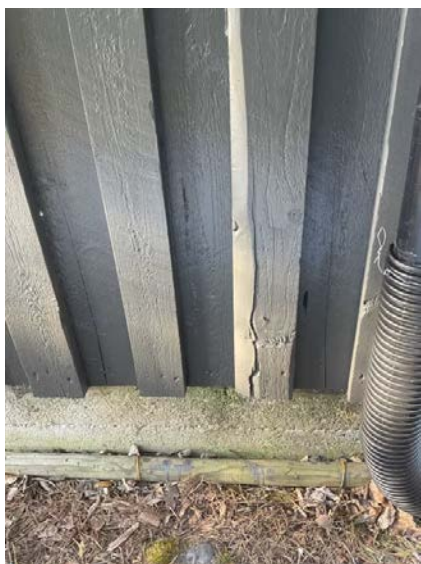
Sprekker i kledning.
