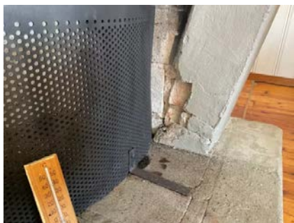
Skade på peis.
