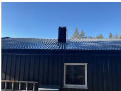
Manglende snøfangere og adkomst for feier.
