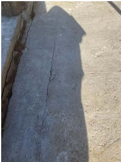
Sprekker og sakder i terrasse.
