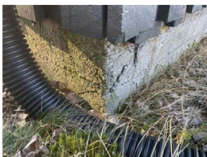
Sprekker i ringmur.
