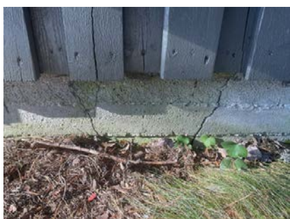
Sprekker i ringmur.
