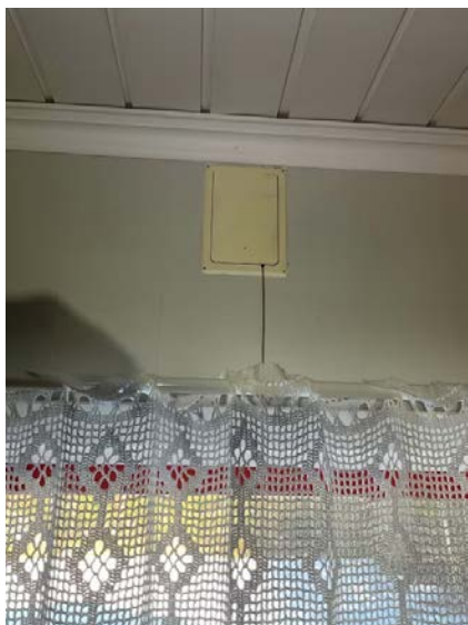
Klaffventiler på yttervegg.
