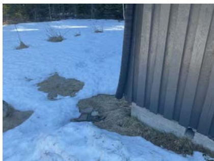
Manglende bortledning av vann.
