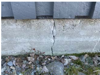
Sprekker i ringmur.
