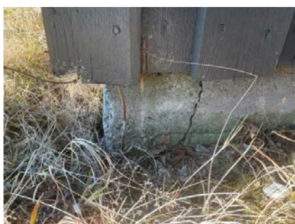
Sprekker i ringmur.
