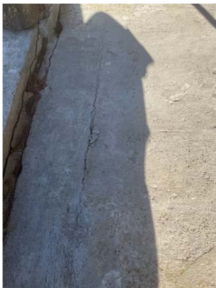
Sprekker og sakder i terrasse.
