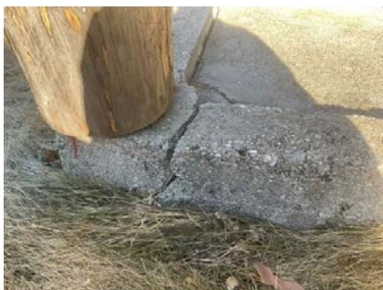
Sprekker i ringmur.
