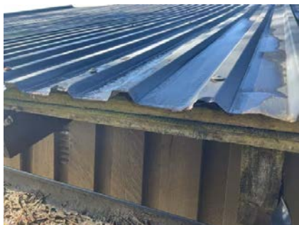
Rust og bulker i takplater.
