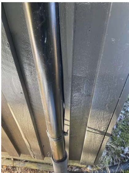
Frostsprenge i nedløp.
