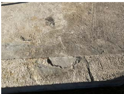
Sprekker og sakder i terrasse.
