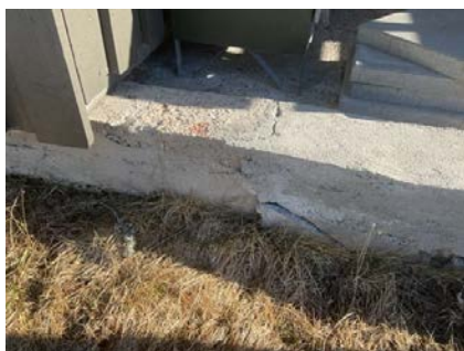
Sprekker i ringmur.
