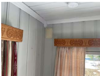
Klaffventiler på yttervegg.
