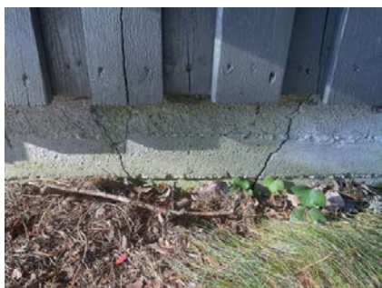
Sprekker i ringmur.
