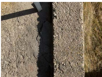
Sprekker og sakder i terrasse.
