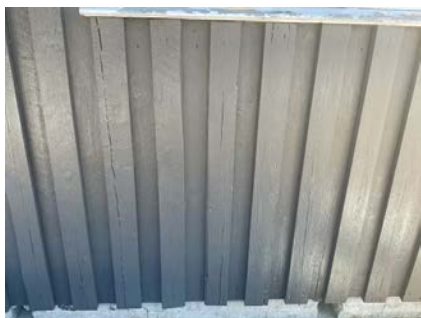
Sprekker i kledning.
