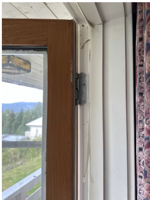
Viser defekt tettelist ved balkongdør.
