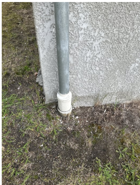
Taknedløp antatt ført til drenering under bakken.
