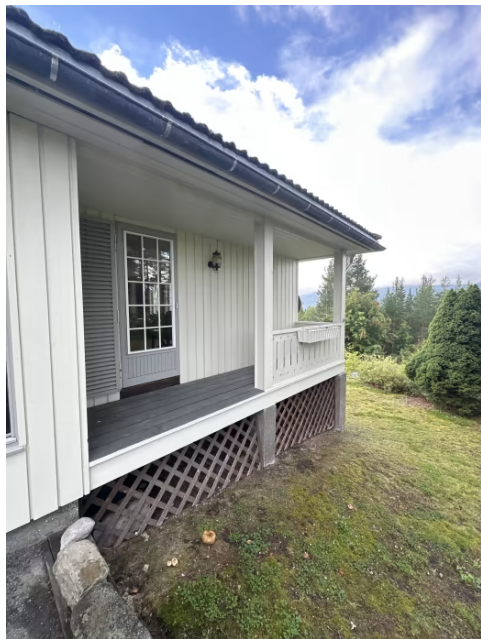
Overbygget balkong. Rekkverk mangler stedvis.
