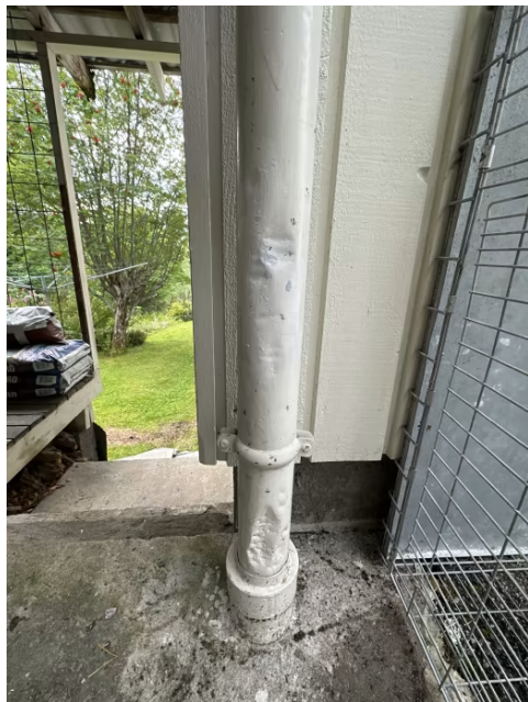
Vise bulker på nedløpsrør.
