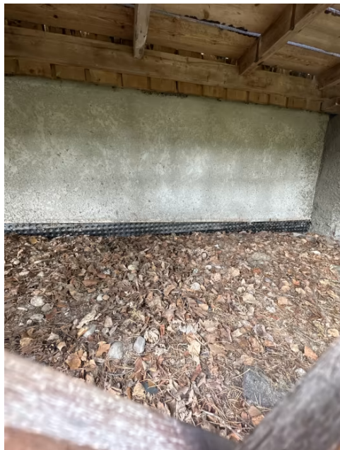
Stedvis synlig knotteplast mot grunnmur.
