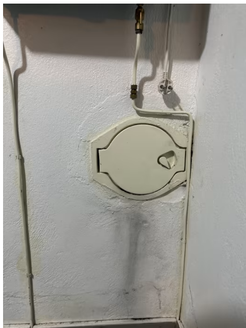
Viser sotluke plassert i bod.
