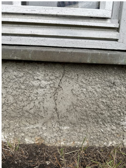
Grunnmuren har sprekkdannelser.
