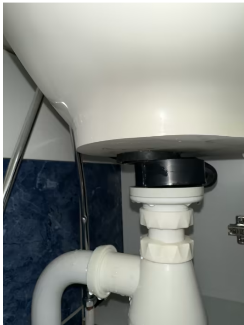
Avløpsrør er ikke festet. Lekkasje.
