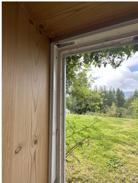
Manglende tetningslister i vindu.
