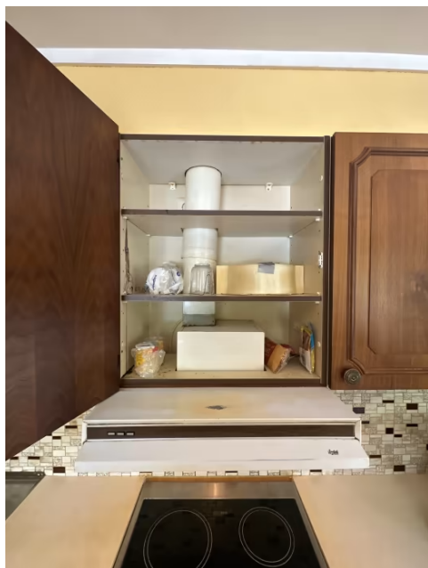
Vifte med mekanisk avtrekk, avtrekk ført ut mot fri.
