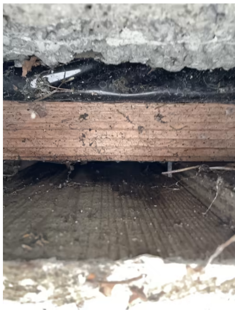
Viser manglende musetetting mellom kledning og veggkonstruksjon.
