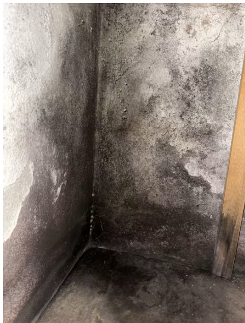
Det registreres fuktighet og salt/kalkutslag på innvendig grunnmursflater i bod kjeller.
