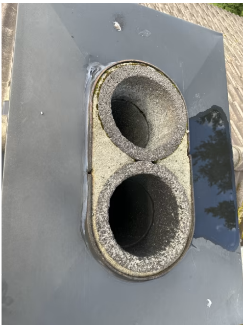
Regnskjerm mangler. Regnvann renner ned i pipeløp.
