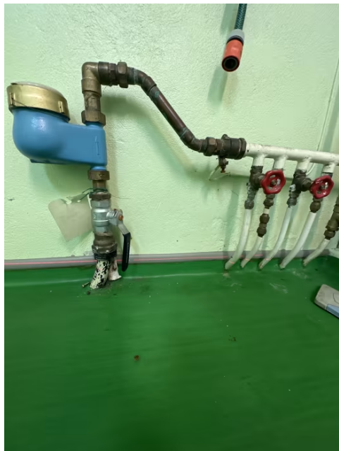
Manglende oppbrett rundt rørgjennomføringer.
