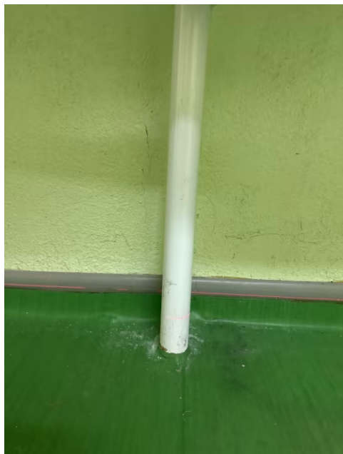
Viser manglende bruk av mansjetter/membran rundt rørgjennomføringer.
