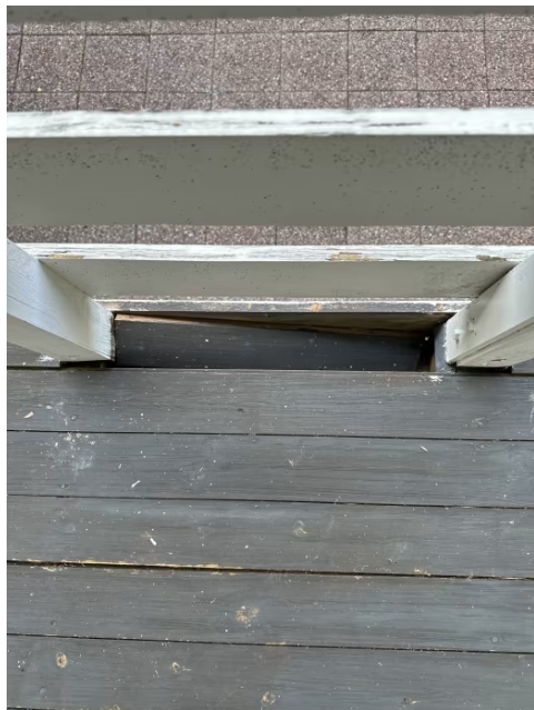
Deler av terrassebord har løsnet.
