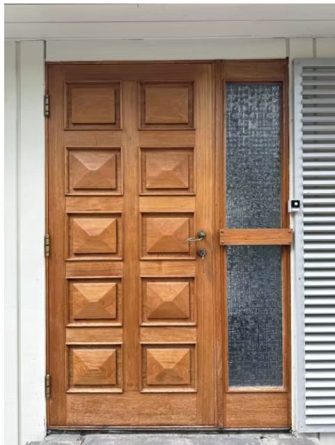
Vis ytterdør. Ytterdør med justeringsbehov.
