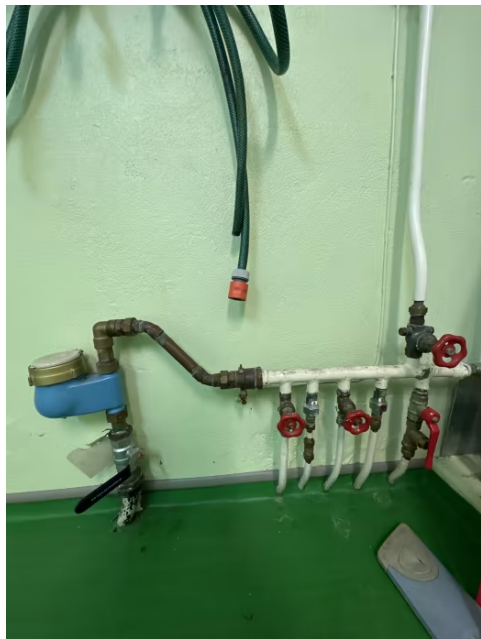
Viser vanninntak, stoppekran og vannmåler på vaskerom.
