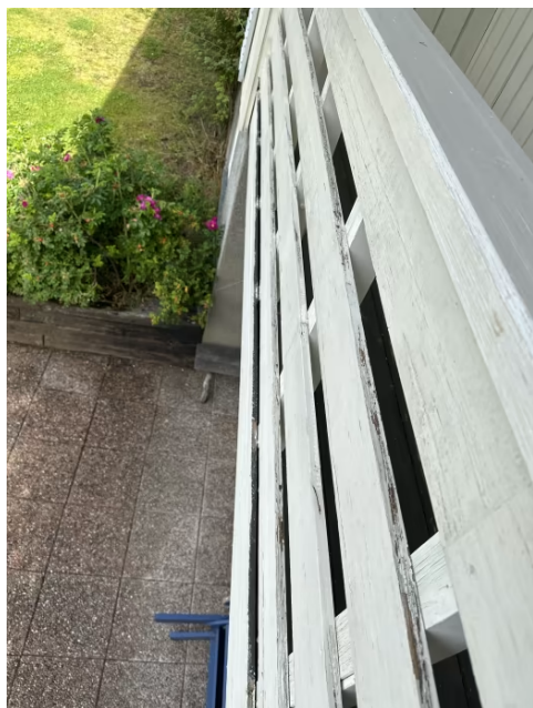
Rekkverk med vedlikeholdsbehov.
