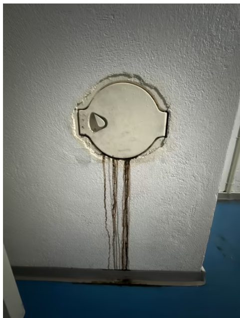
Sotluke i kjeller i bod. Påvist sotvann fra luke, dette kan tyde på kondensering eller manglende regnskjerm.
