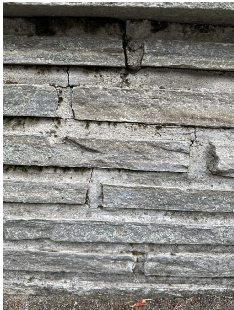
Sprekkdannelser i støttemur.
