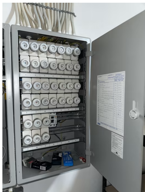
Viser vegghengt sikringsskap plasser i kjellerbod.
