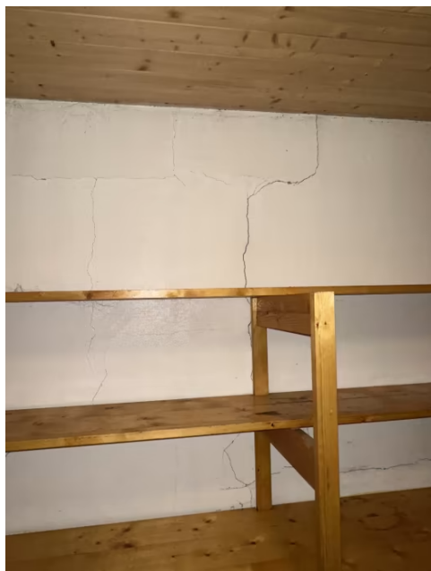
Viser sprekkdannelser innvendig.
