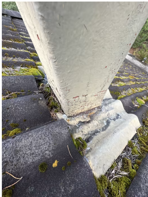
Viser rustdannelser/ oppsprekking på beslag.
