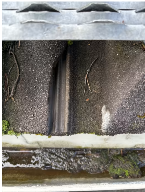
Viser knekt hjørne på takstein.
