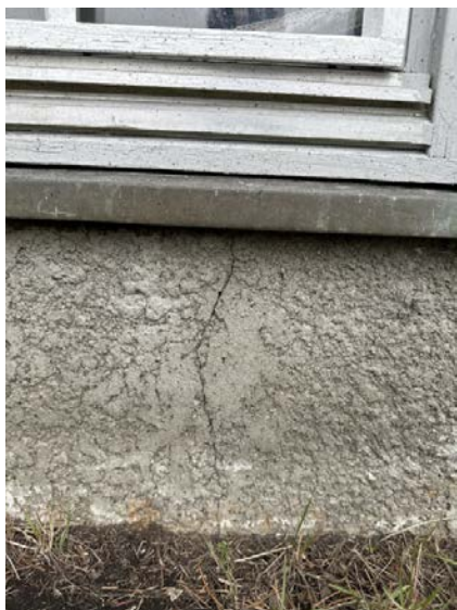
Grunnmuren har sprekkdannelser.
