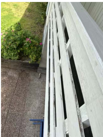
Rekkverk med vedlikeholdsbehov.
