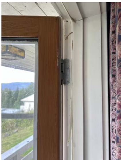
Viser defekt tettelist ved balkongdør.
