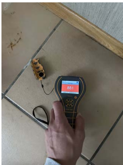
Forhøyde målinger mot fliser i gang. Ukjent bruk av fuktsikring mot grunn.
