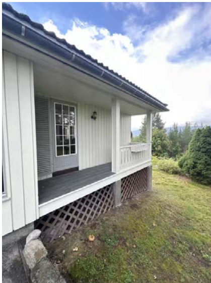
Overbygget balkong. Rekkverk mangler stedvis.
