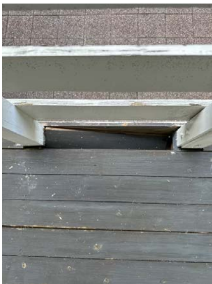
Deler av terrassebord har løsnet.
