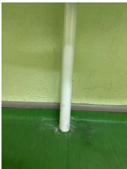
Viser manglende bruk av mansjetter/membran rundt rørgjennomføringer.
