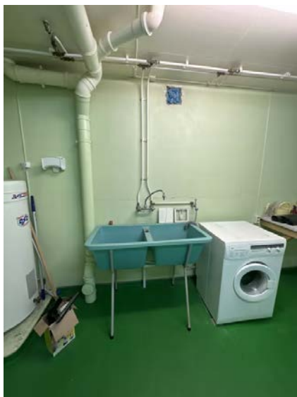
Viser gulvstående vask, veggghengt blandebatteri og opplegg for vaskemaskin.
