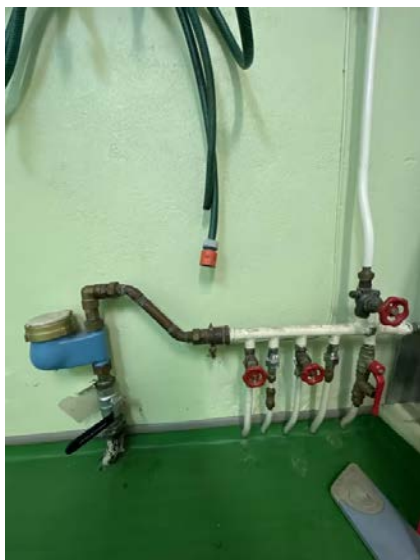
Viser vanninntak, stoppekran og vannmåler på vaskerom.
