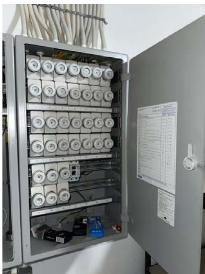
Viser vegghengt sikringsskap plasser i kjellerbod.
