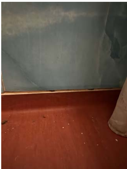
Manglende fuger i nedkant av baderomsplater gir fuktopptrekk i plater.
