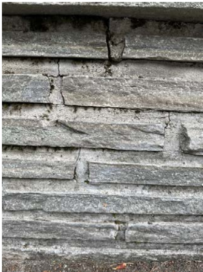
Sprekkdannelser i støttemur.
