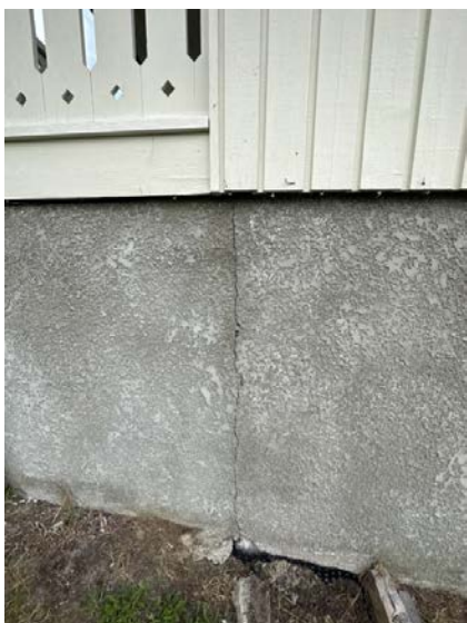
Grunnmuren har sprekkdannelser.
