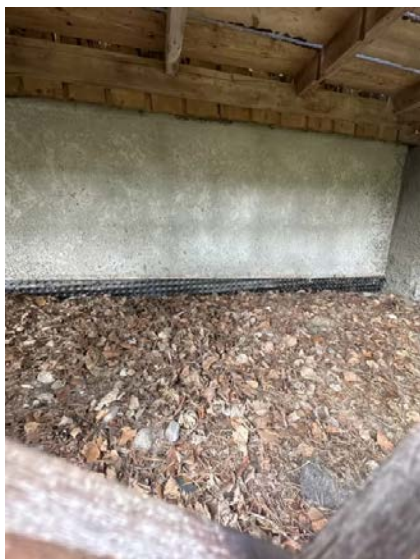
Stedvis synlig knotteplast mot grunnmur.
