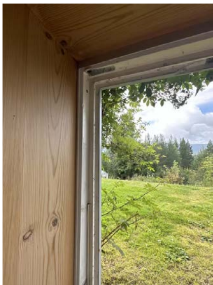
Manglende tetningslister i vindu.
