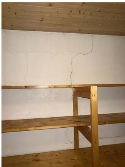
Viser sprekkdannelser innvendig.
