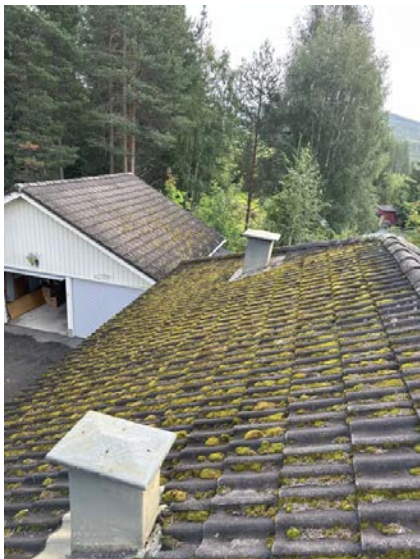
Store deler av taket er mosegrodd. Tak med behov for rengjøring.
