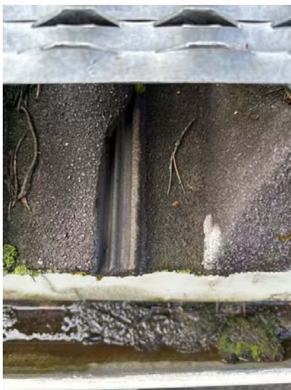
Viser knækt hjørne på takstein.
