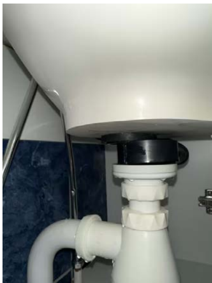
Avløpsrør er ikke festet. Lekkasje.
