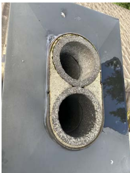
Regnskjerm mangler. Regnvann renner ned i pipeløp.
