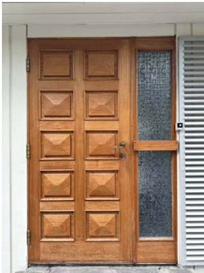
Vis ytterdør. Ytterdør med justeringsbehov.
