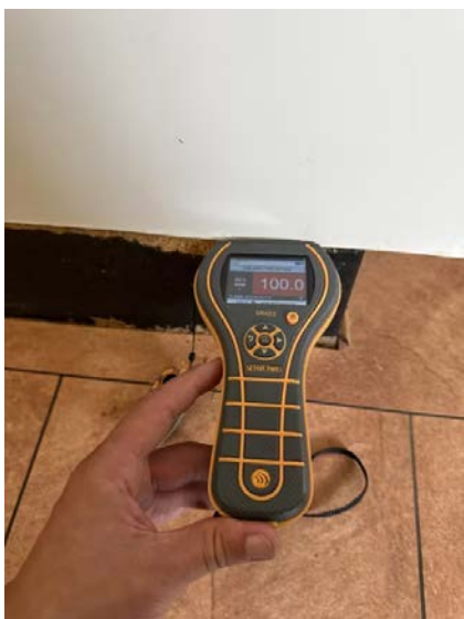
Målt forhøyde fuktverdier i sokkel. Sokkel er fast og begrenser besiktigelsen. Anbefaler videre undersøkelser.
