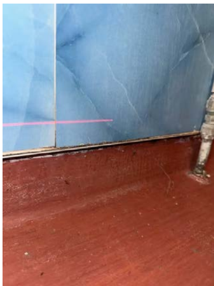
Viser fuktskadede baderomsplater, plater trekker fukt i underkant.
