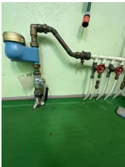
Manglende oppbrett rundt rørgjennomføringer.
