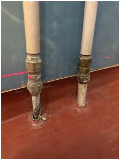
Viser manglende mansjetter/oppbrett rundt rørgjennomføringer.
