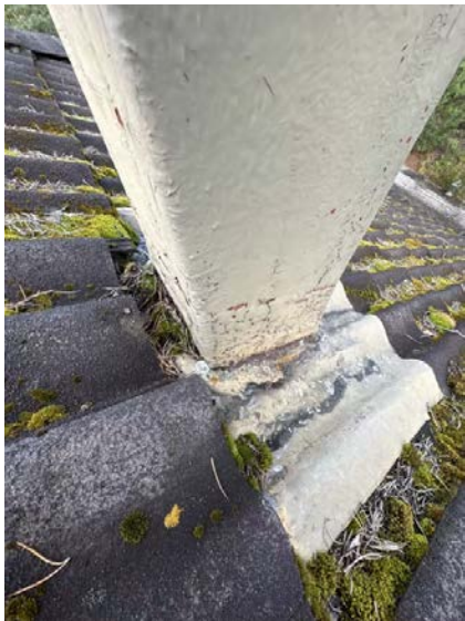
Viser rustdannelser/ oppsprekking på beslag.
