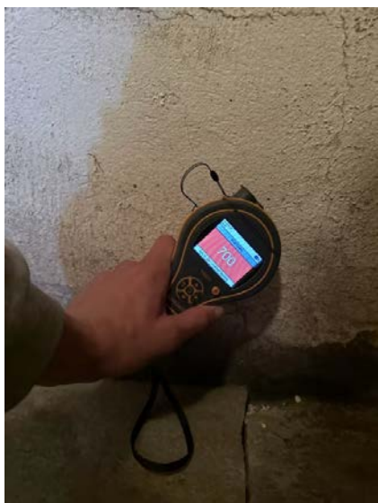
Fuktmåling viser fukt i innvendige overflater på grunnmur.
