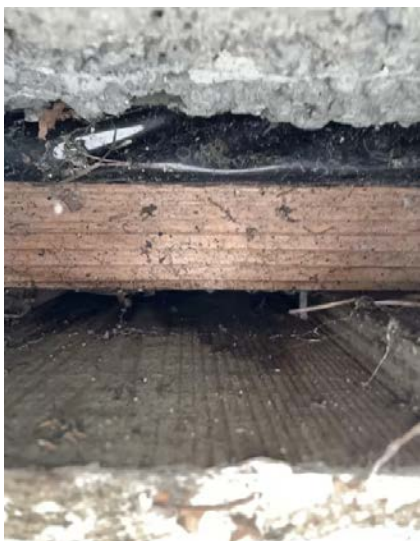
Viser manglende musetetting mellom kledning og veggkonstruksjon.
