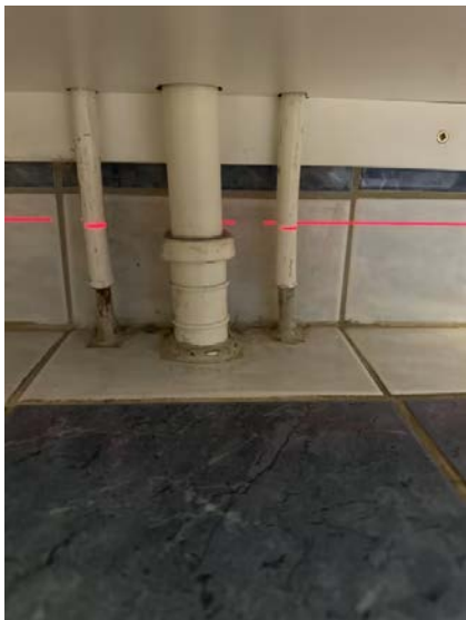
Ikke tilfredstillende oppbrett av membran/ mansjetter rundt rørgjennomføringer.
