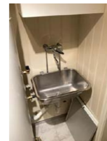
Manglende membran bak utslagsvask.
