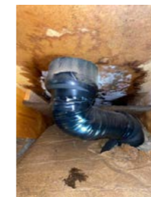
Lekkasje rundt gjennomføring.
