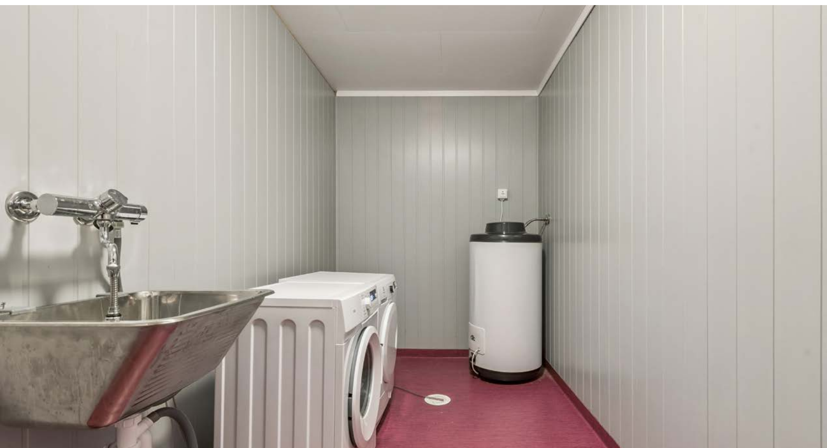
Vaskerommet tilhører hoveddelen og er utstyrt vaskekar og 200 liters varmtvannsbereder.
