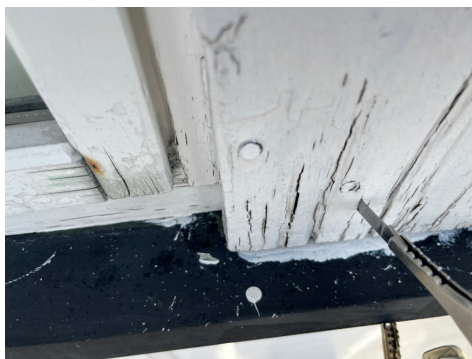
Råteskader i bord ved vindu
