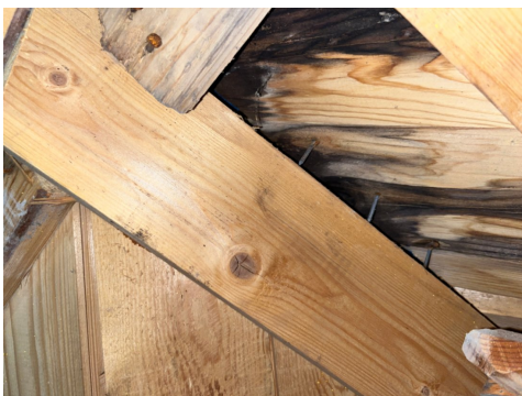
Misfarging i undertak.
