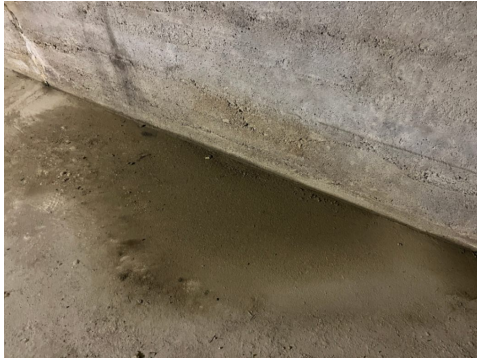
Synlig fukt på kjellergulv.
