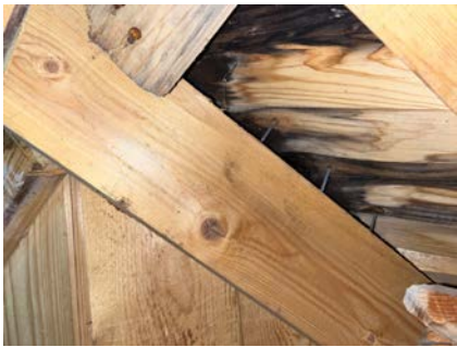
Misfarging i undertak.
