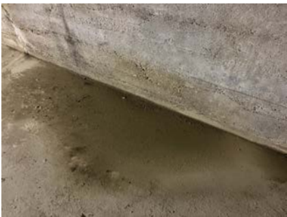
Synlig fukt på kjellergulv.
