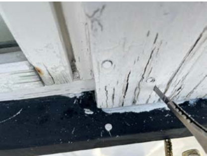
Råteskader i bord ved vindu
