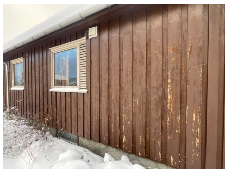
Slitt utvendig kledning
