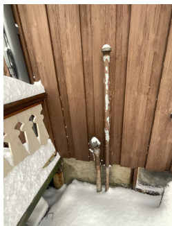
Påfyllingsrør og lufting for nedgravd oljetank.
