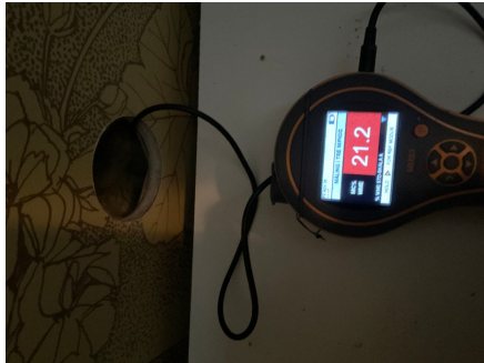
Fukt i bunnsvill mot bad.
