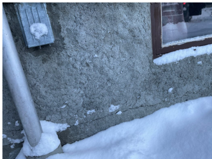
Utvendig sprekk/riss i puss/grunnmur
