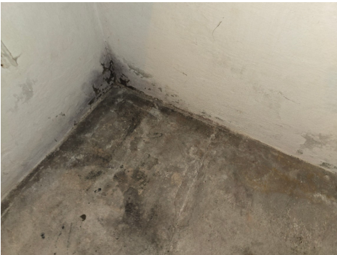
Fuktinnsig i kjeller
