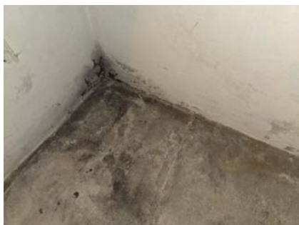
Fukttinnslag i kjeller
