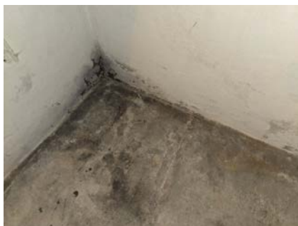
Fuktinnsig i kjeller
