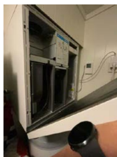
Ventilasjons aggregatet er plassert i bod.
