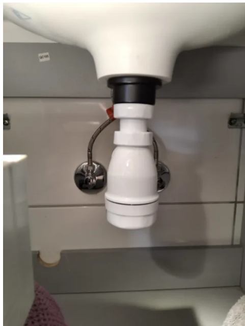
Synlige avløpsrør av plast i leiligheten.
