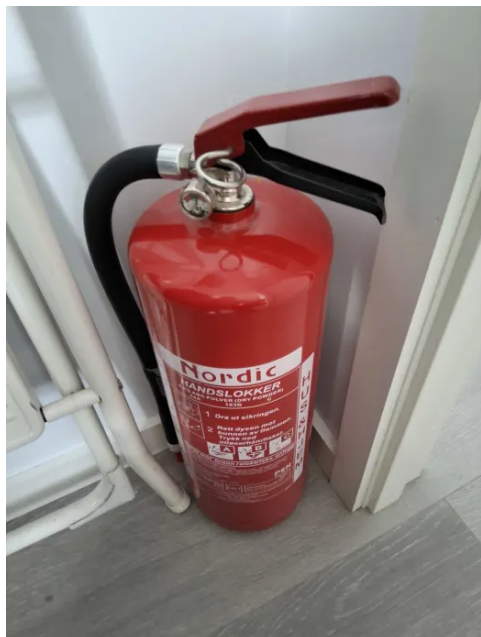
Brannslukningsapparat er plassert på soverom.
