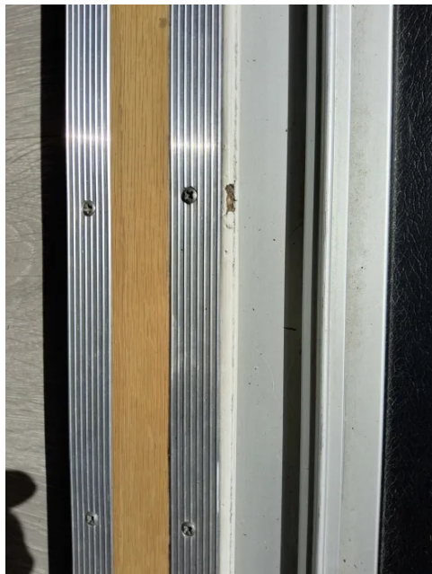
Det registreres en skade på pakning til skyvedør.
