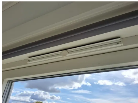
Naturlig tilluft fra spalteventil i vindu.
