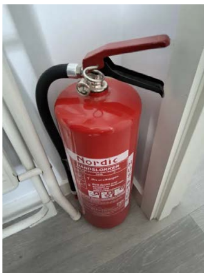
Brannslukningsapparat er plassert på soverom.
