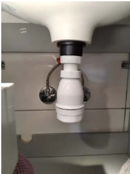
Synlige avløpsrør av plast i leiligheten.
