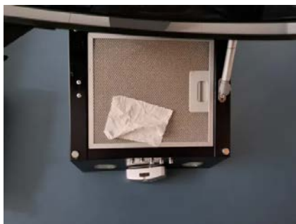
Avtrekkseffekten er testet med papir.
