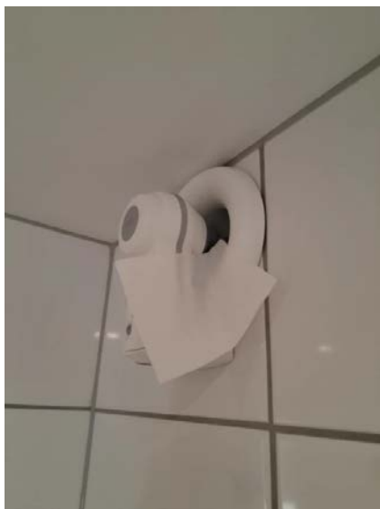
Avtrekkseffekt er testet med papir.
