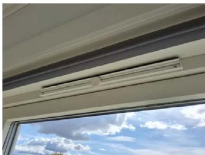
Naturlig tilluft fra spalteventil i vindu.
