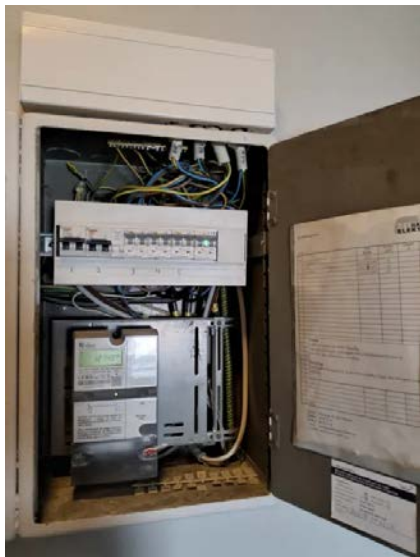
Sikringsskap er plassert i felles trappeoppgang.
