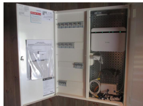
Sikringskapet er plassert i hall og har merkede kurser.
