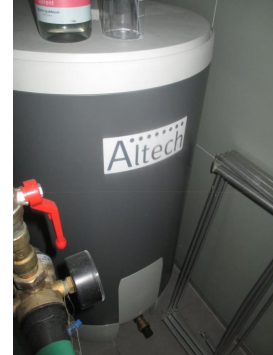
Bereider er plassert på bad/vaskerom.
