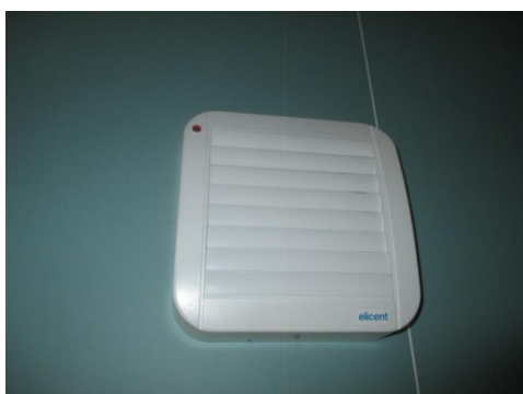
Vifte i ytterveggen på bad.
