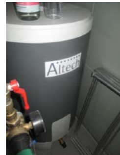
Bereder er plassert på bad/vaskerom.
