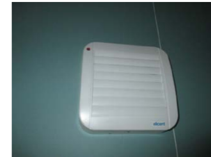
Vifte i ytterveggen på bad.
