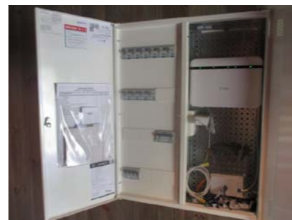
Sikringsskapet er plassert i hall og har merkede kurser.
