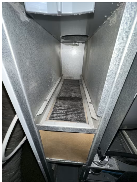
Filter er tilsmusset og bør skiftes.
