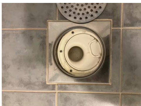
Viser sluk i dusjsonen.
