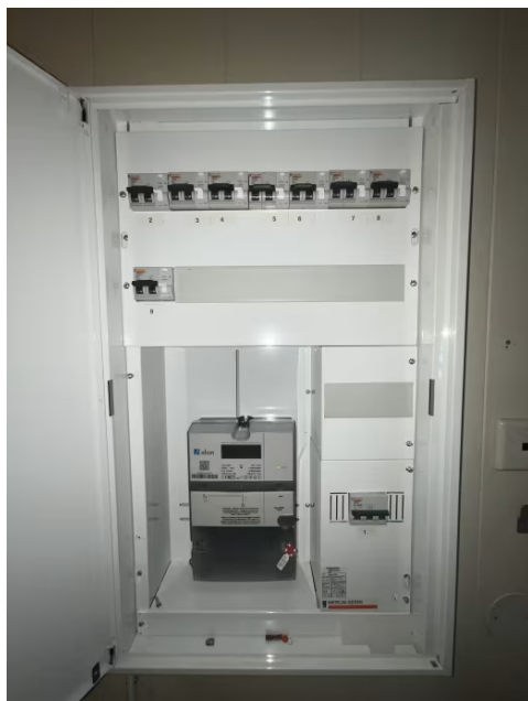
Viser sikringskap plassert i bod.
