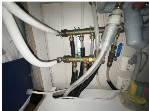
Vannrør med rør i rør system fra åpen fordeler plassert under kum på kjøkken og frem til sanitærinstallasjoner på badrom og kjøkken.
