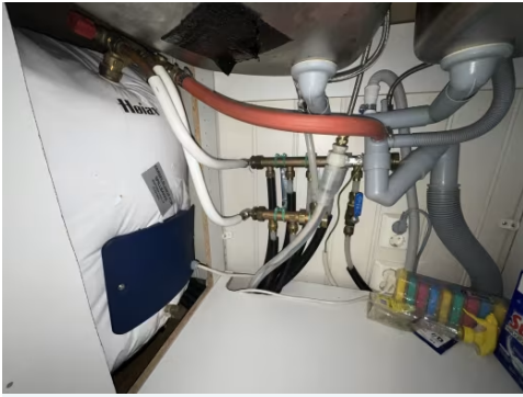
Viser vann og avløpsinnstallasjoner under kum.
