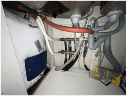
Viser vann og avløpsinnstallasjoner under kum.
