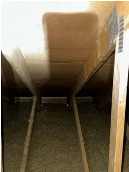
Det er begrenset/dårlig ventilering av takkonstruksjonen ved raft.
