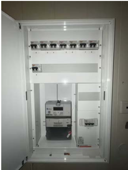
Viser sikringsskap plassert i bod.
