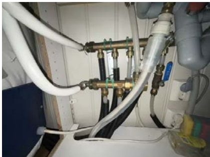
Vannrør med rør i rør system fra åpen fordeler plassert under kum på kjøkken og frem til sanitærinstallasjoner på badetrom og kjøkken.
