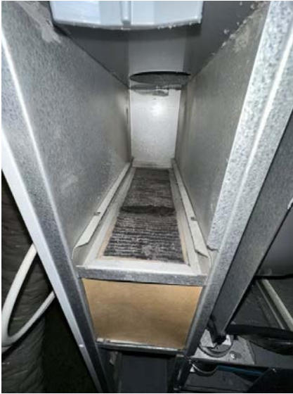
Filter er tilsmusset og bør skiftes.
