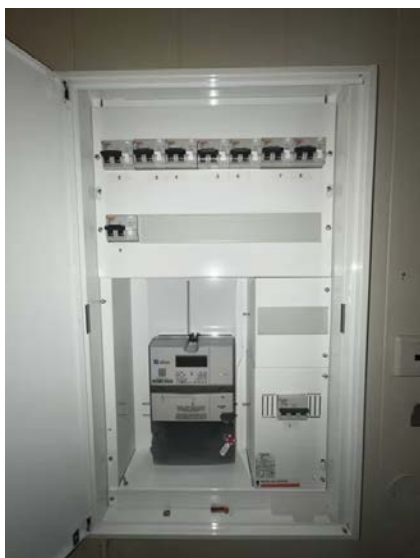
Viser sikringsskap plassert i bod.
