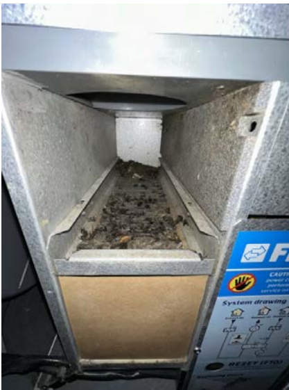
Filter bør skiftes og anlegget må rengjøres.
