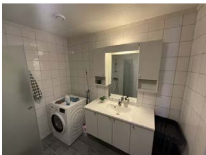
Viser baderomsinnredning og opplegg for vaskemaskin.
