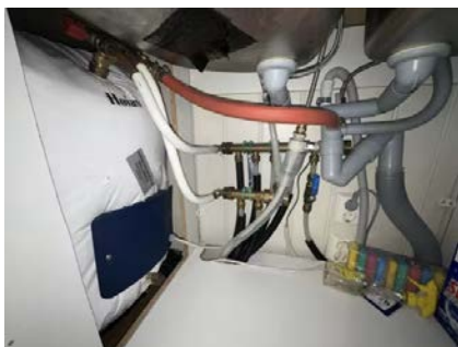
Viser vann og avløpsinnstallasjoner under kum.
