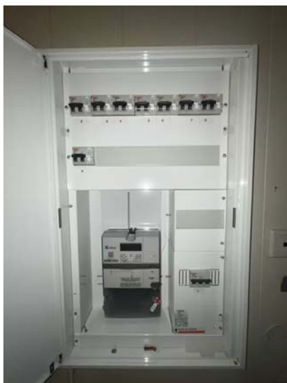
Viser sikringsskap plassert i bod.
