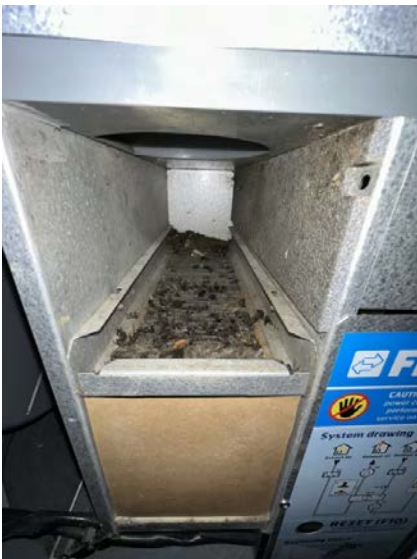
Filter bør skiftes og anlegget må rengjøres.
