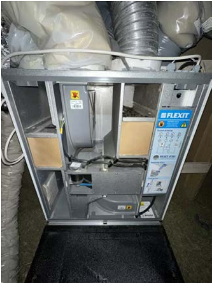
Balansert ventilasjon fra Flexit, aggregat plassert på loft.
