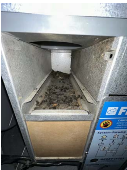
Filter bør skiftes og anlegget må rengjøres.
