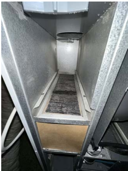
Filter er tilsmusset og bør skiftes.
