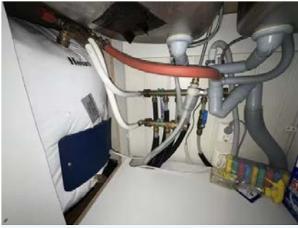
Viser vann og avløpsinnstallasjoner under kum.
