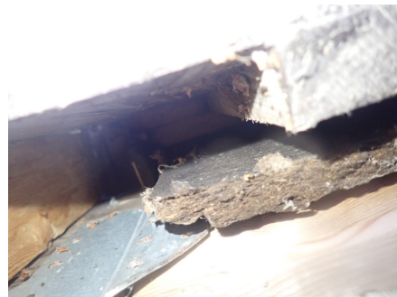
Tegn på utettheter i vindtetting i nedre del av veggkonstruksjon på opprinnelig del.
