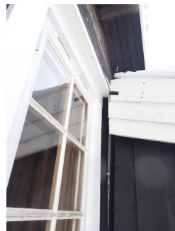
Boden har løsnet fra boligen. Kommer tydelig frem i overgangen.
