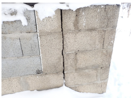
Store sprekker i lettklinkerblokker.
