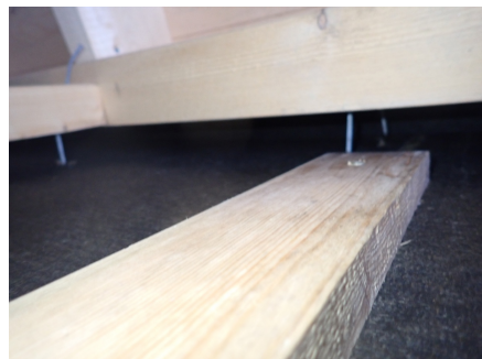
Takkonstruksjon på bod har løsnet fra vegg mot boligen.
