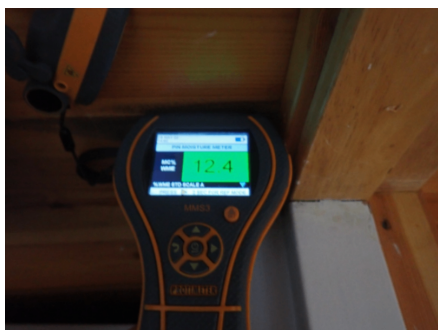
Målt noe høyere utslag ved fuktmerke, enn i området rundt.
