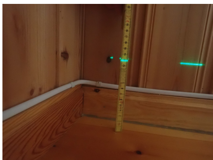
Målt skjevhet på ca. 90 mm i stue.
