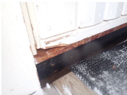
Avsprukket trevirke i ytterdør.
