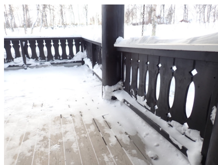
Tydelig skjevhet i konstruksjonen.
