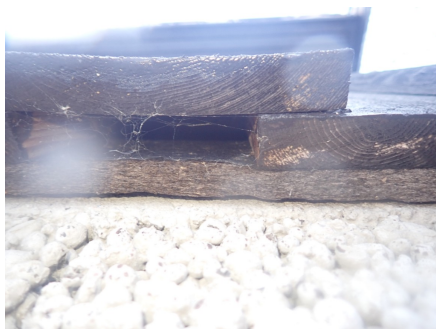
Manglende musetetting på opprinnelig del.
