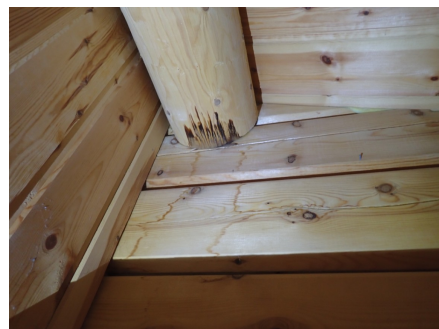
Skjolder / avrenning oppunder takås.
