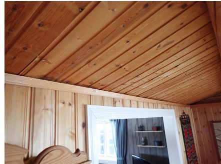
Tydelige skjevheter mellom tak og taklist som er innfestet i vegg.
