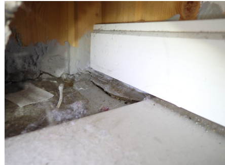
Skader i membran, samt noe variabel utførelse av tettesjikt opp på veggen.
