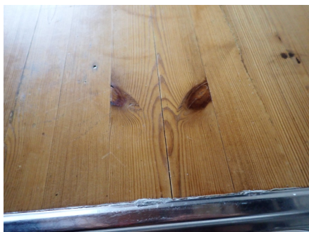
Sprekker i benkeplate.
