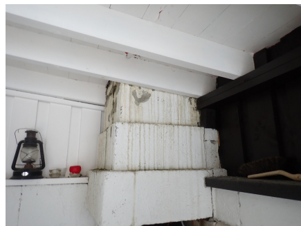
Rennemerker fra pipegjennomføring, samt sprekker i pipemur.
