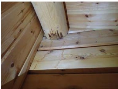
Skjolder / avrenning oppunder takås.
