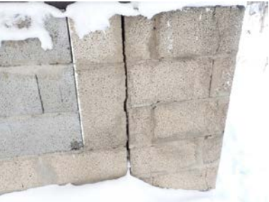
Store sprekker i lettklinkerblokker.
