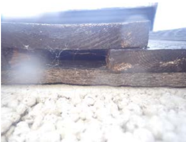
Manglende musetetting på opprinnelig del.
