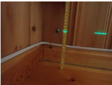
Målt skjevhet på ca. 90 mm i stue.
