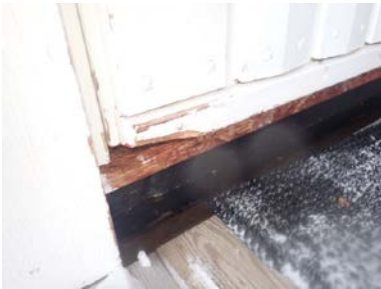
Avsprukket trevirke i ytterdør.
