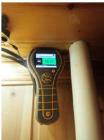
Måling ved fuktmerke i gulv. Risiko for skadeutvikling.
