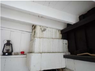
Rennemerker fra pipegjennomføring, samt sprekker i pipemur.
