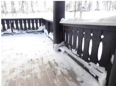
Tydelig skjevhet i konstruksjonen.
