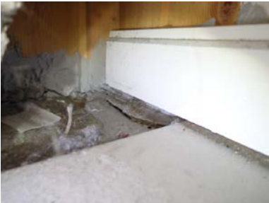
Skader i membran, samt noe variabel utførelse av tettesjikt opp på vegg.
