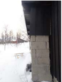
Større skjevheter i vegg. Her kan det også ses en knekk mellom konstruksjonsdeler.
