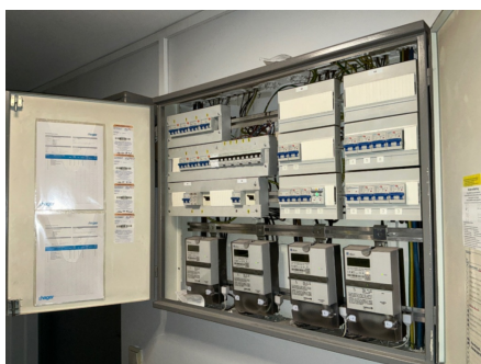
Automatsikringer i felles sikringsskap plassert i gang/fellesareal.
