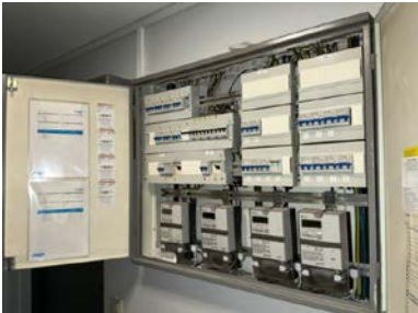
Automatsikringer i felles sikringsskap plassert i gang/fellesareal.
