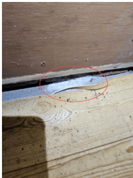
Indikasjon på noe saltutslag ved grunnmur i kjeller
