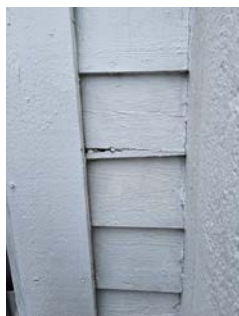
Det er værslitt/oppsprukket trevirke/trepaneler.
