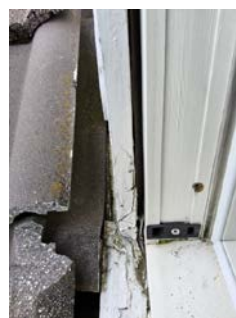
Det er påvist avvik rundt innsettsdetaljer. Glippe mellom utvendig listverk og vindu. Vannbrett har fallt mot vindu.
