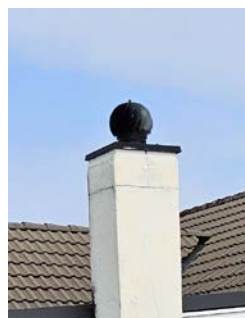
Det observeres noe sprekk i skjøt på øverste element utvendig på pipe ved hagestue
