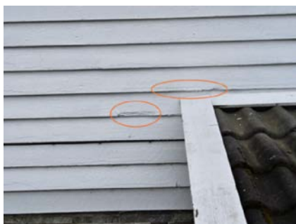
Det er påvist spredte råteskader i bordkledningen.
