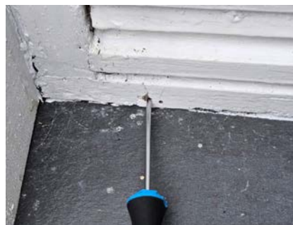
Det er påvist vinduer med fukt/råteskader.
