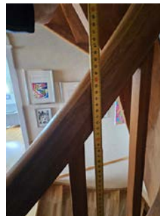
Rekkverkshøyder er under dagens forskriftskrav til rekkverk i trapper.
