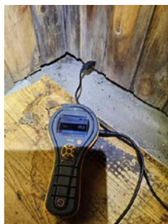
Det er registrert fuktskjolder/fuktskader på overflater.
