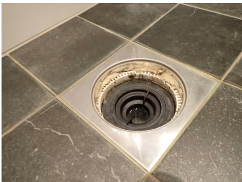
Slukløsning med synlig slukmansjett og
