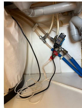
Røropplegg i kjøkkenbenk med Waterguard
