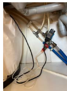
Røropplegg i kjøkkenbenk med Waterguard
