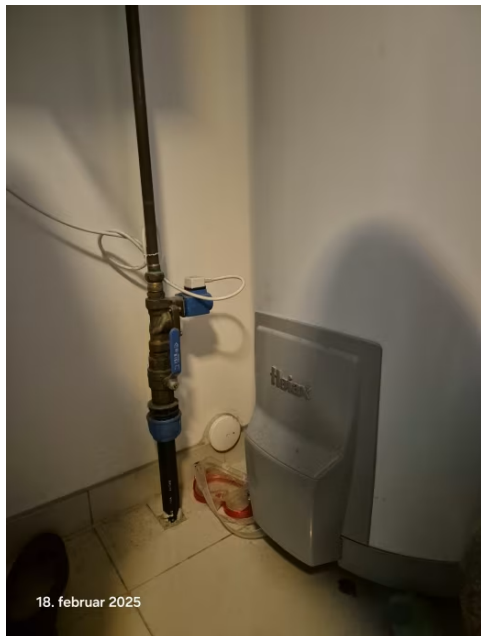
Merking av stoppekran mangler.
