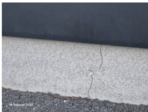
Sprekk i ringmurs-element, men kun i utvendig overflate.
