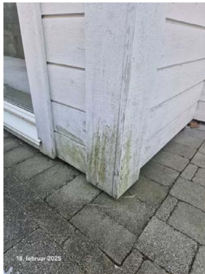
Noe grønne finnes. Normal vask og vedlikehold av fasade må påregnes.
