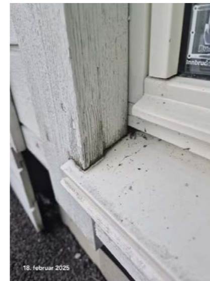
Påbegynnende råteskade på listverk og utforing, på grunn av manglende lufting.
