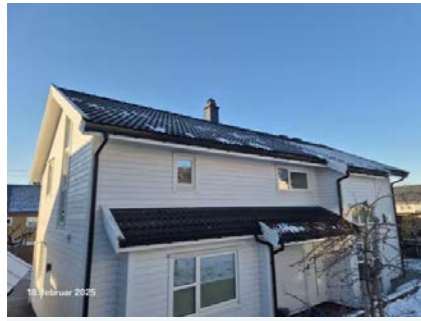
Snøfangerer på tak mangler.
