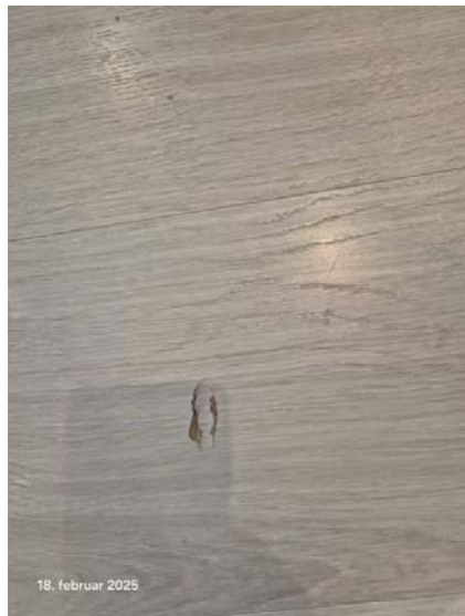
Skade i laminat på kjøkkenet.
