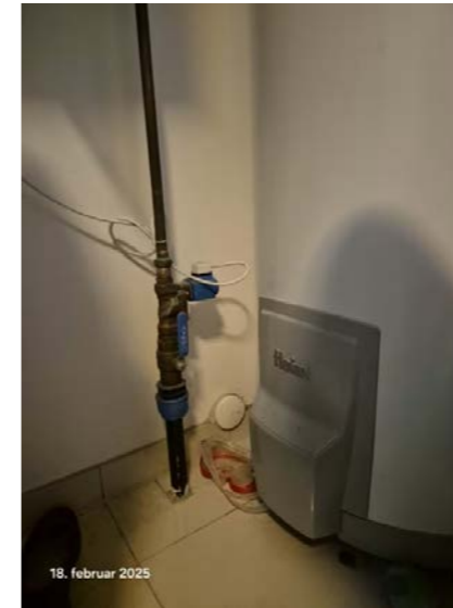
Merking av stoppekran mangler.
