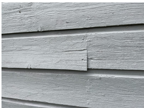
Værslitt, vridd kledning.
