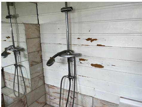
Råteskader i panel
