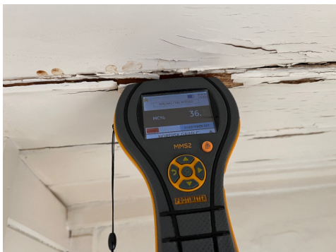
Råteskader i tak 2.etg.
