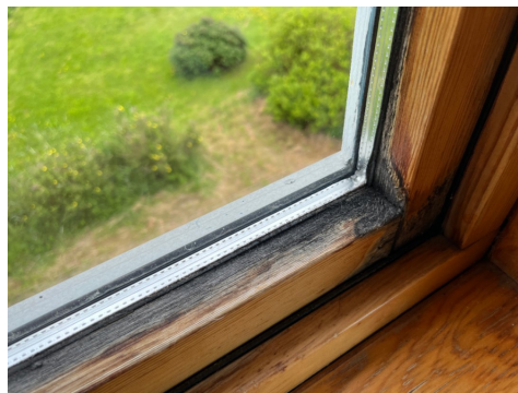
Svertesopp og stor slitasje ut-og innvendig på vinduer.
