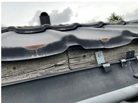
Råteskade i treverk bak takrenner.
