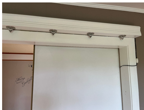
Innfelt lys koblet med skjøtekabel
