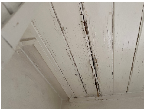
Råteskader i himling
