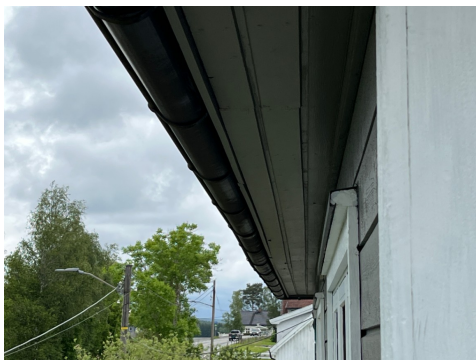
Manglende lufting av takkonstruksjon
