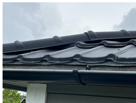
Ujevnt lagt tak- plater.
