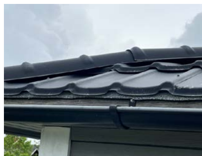
Ujevnt lagt tak- plater.
