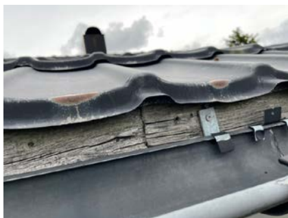
Råteskade i treverk bak takrenner.
