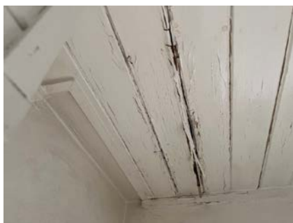
Råteskader i himling
