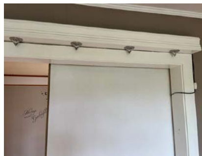
Innfelt lys koblet med skjøtekabel
