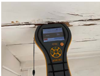
Råteskader i tak 2.etg.
