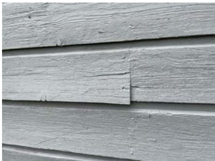
Værslitt, vridd kledning.
