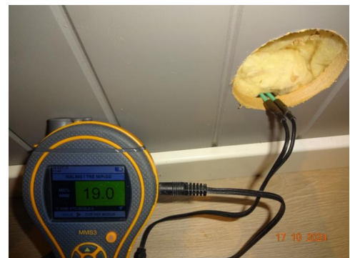
Fuktmåling i kjelleryttervegg.
