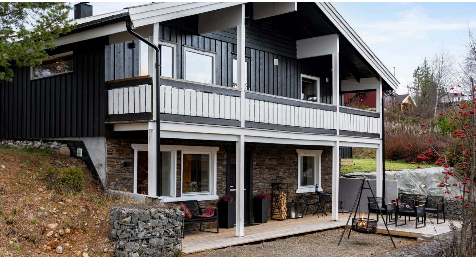
I 2019 fikk boligen ny isolasjon, større deler fikk ny panel og kledningen ble overflatebehandlet.
