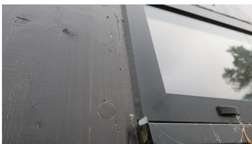
Foto 14. Daskerudvegen 62. Smalt vindu på nordveggen. Elastisk fuge mellom vindu og vegg. Høyt fuktinnhold i KLT inn mot vinduet.
