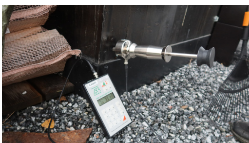
Foto 12. Daskerudvegen 64, byggetrinn 2/3. Svært høyt fuktinnhold i KLT-elementet bak dekkbordet i hjørnet.
