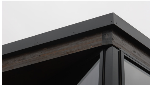
Foto 5. Byggetrinn 2 og 3 har en stålsøyle i hjørnet mellom sørvinduet og vinduet på vest- eller østvegg. Skjøt mellom veggelementer i KLT opp mot taket er utildekket.
