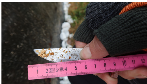
Foto 7. På østveggen i nr. 94 kunne kniven lett stikkes 55 mm inn i trevirket.
