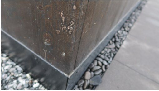
Foto 3. Det er slisset inn et beslag i nedre del av massivtreplatene på veggen. Beslaget står vinkelrett inn i veggen og dekker overgangen mellom platene og isolasjonen rundt støpen de står på. Denne hytta er fra byggetrinn 2 eller 3 og har et bord som dekker endekanten av veggplatene i hjørneskjøten.
