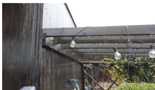
Foto 13. Daskerudvegen 94. Fuktinnhold over 28 vektprosent i overkant av innfesting for pergola, 25 vektprosent i underkant av innfestingen.
