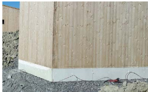
Foto 2. Foto mottatt fra Svein Aaserud som viser en hytte under oppføring. Det er lagt isolasjonsplater som kuldebroyter utvendig på den støpte sålen.
