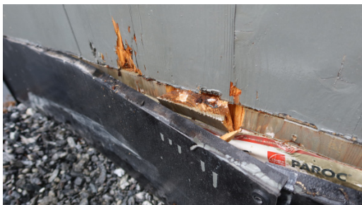
Foto 8. Daskerudvegen 50, østvegg. Her er trevirket nedbrutt ca. 4 cm inn i vegg, dvs. at de to ytre lamellene er berørt. Beslaget ble løsnet fra vegg, og man ser hvordan det er slisset inn i ytre lamell i KLT-elementet. Overgangen mellom KLT og betong er tapet.
