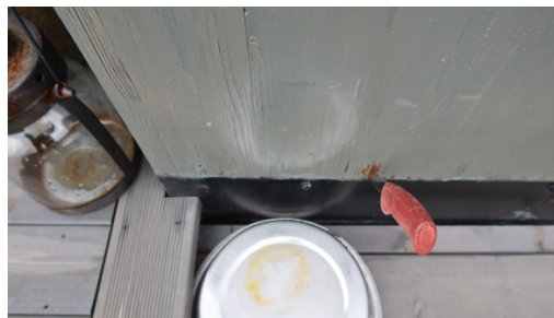
Foto 11. Daskerudvegen 100, sørvegg. Skade nederst mot beslag, berører ytre lamell.
