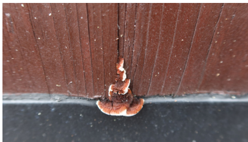
Foto 9. Daskerudvegen 90, sørvegg. Fruktlegeme av vedmusling. Skaden berører trolig de to ytre lamellene.
