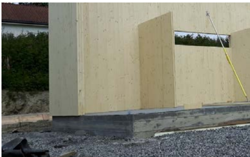
Foto 1. Foto mottatt fra Svein Aaserud som viser en hytte under oppføring. Det er støpt plate på mark, og KLT-elementene i ytterveggene er montert på støpen med litt overheng på utvendig side.
