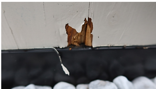
Foto 10. Daskerudvegen 149, østvegg. Skade nederst mot beslag, berører ytre lamell.
