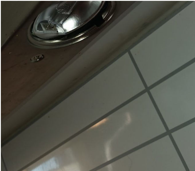
Bilde 1 Lyslist under overskap kjøkken har også halogen pærer.
