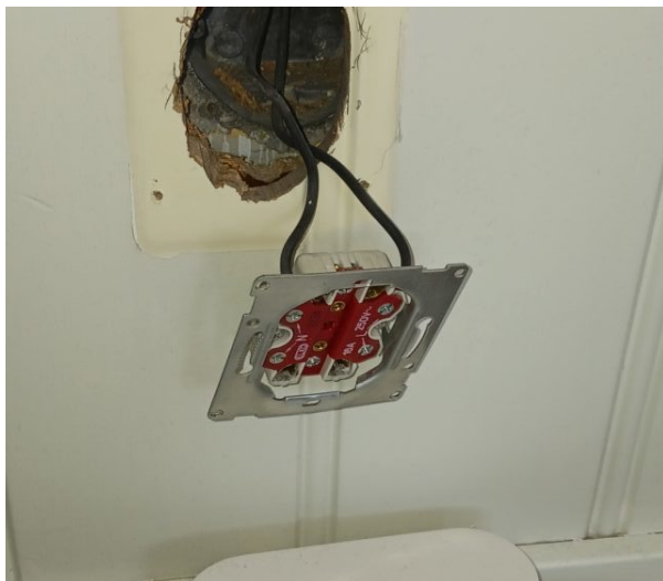
Bilde 1 Vegg lektet ut og ledninger ligger så mot brennbart.
