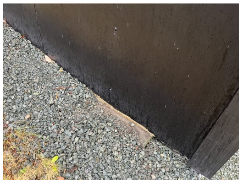
Manglende lufting av fasadeplater.
